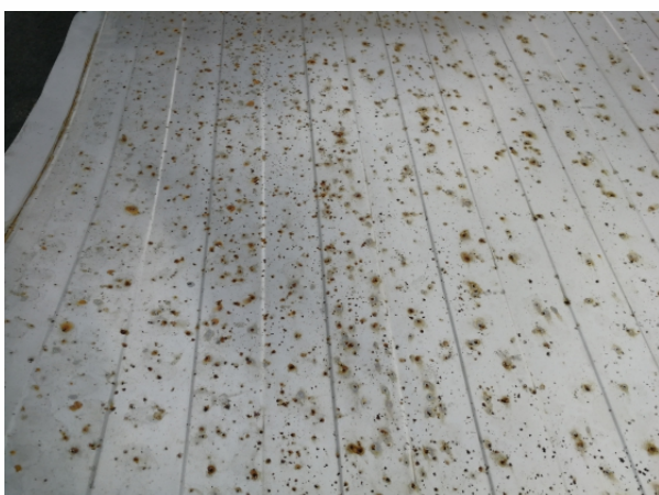
03. Zaawansowana korozja wżerowa
