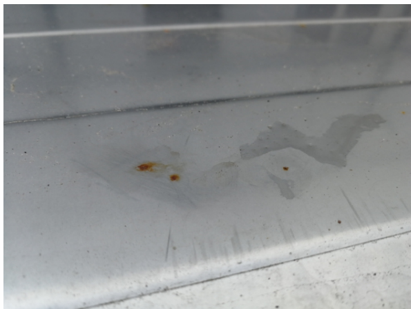
02. Rozwijająca się korozja wżerowa
