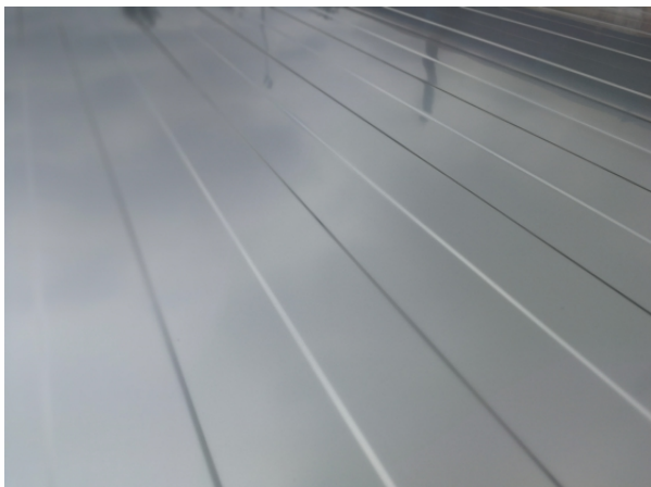
01. Płyta w stanie nienaruszonym
